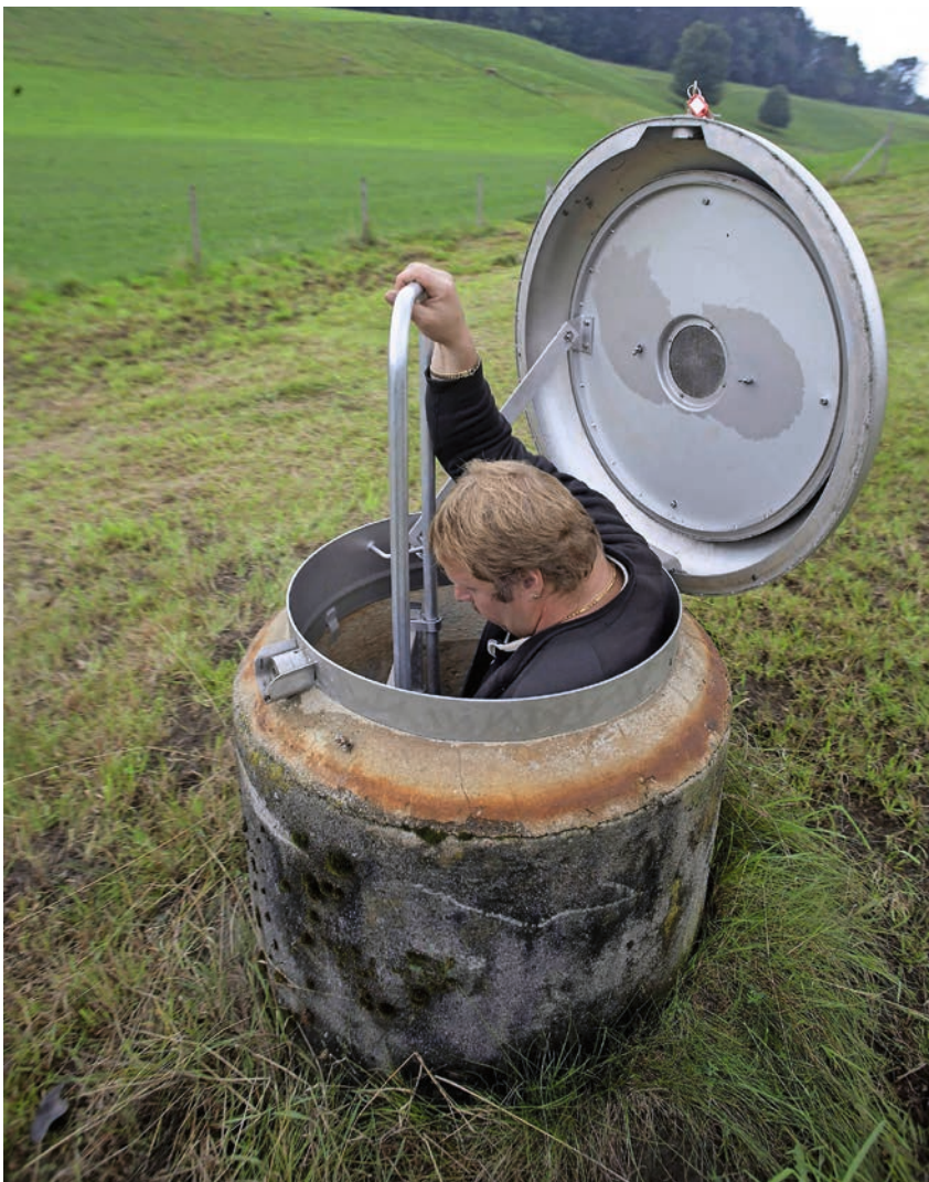
Beim Vollzug der Schutzzonen und Zuströmbereiche rund um Trinkwasserfassungen bestehen noch immer Defizite.
